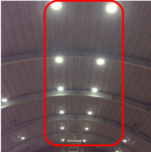
赤丸がLED照明への更新部分
